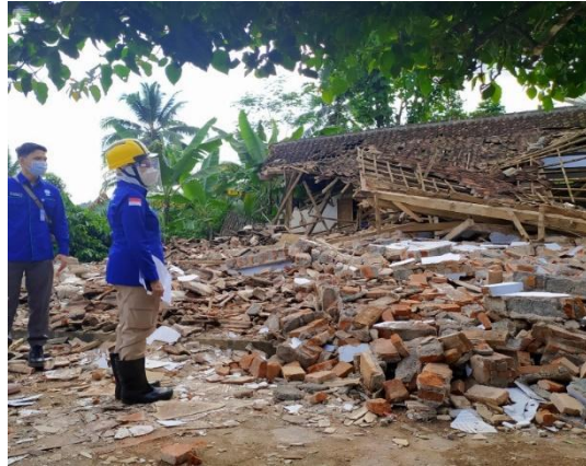
Gambar 3 : Kerusakan akibat Gempa
